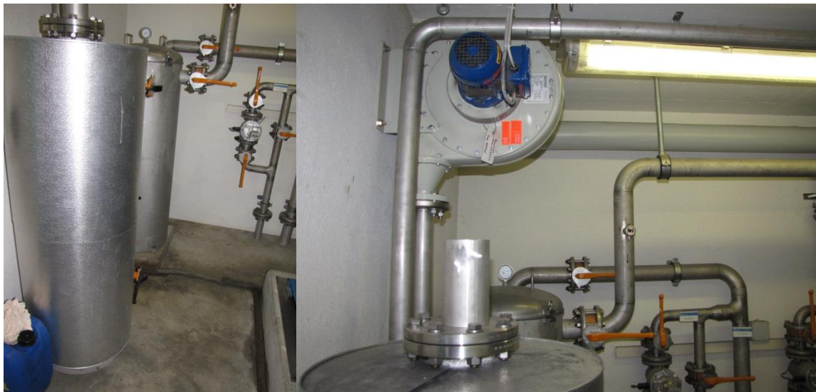
Abbildung 1 Siloxanfilter und Gasdruckerhöhungsgebläse im Gasraum
