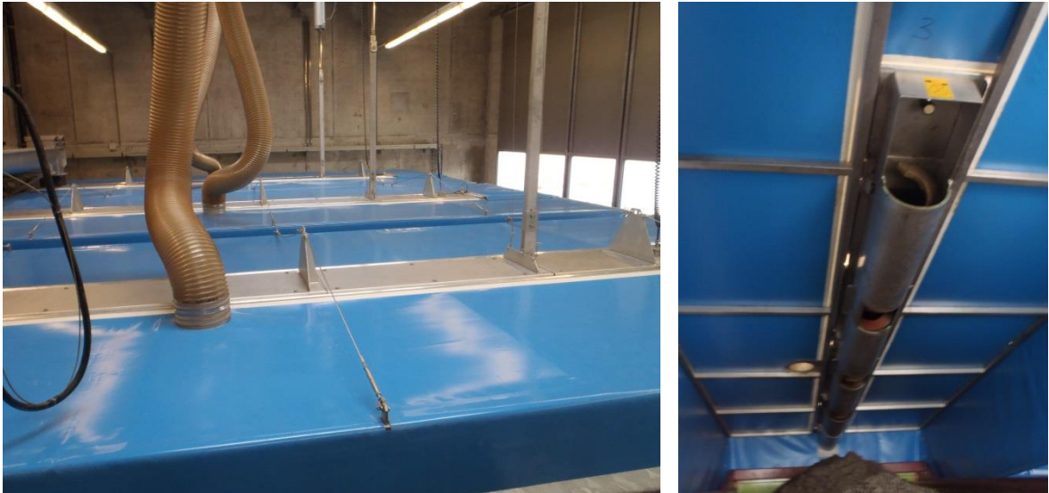
Abbildung 8: Muldenbefüller kombiniert mit Abdeckung in der ARA Meilen
