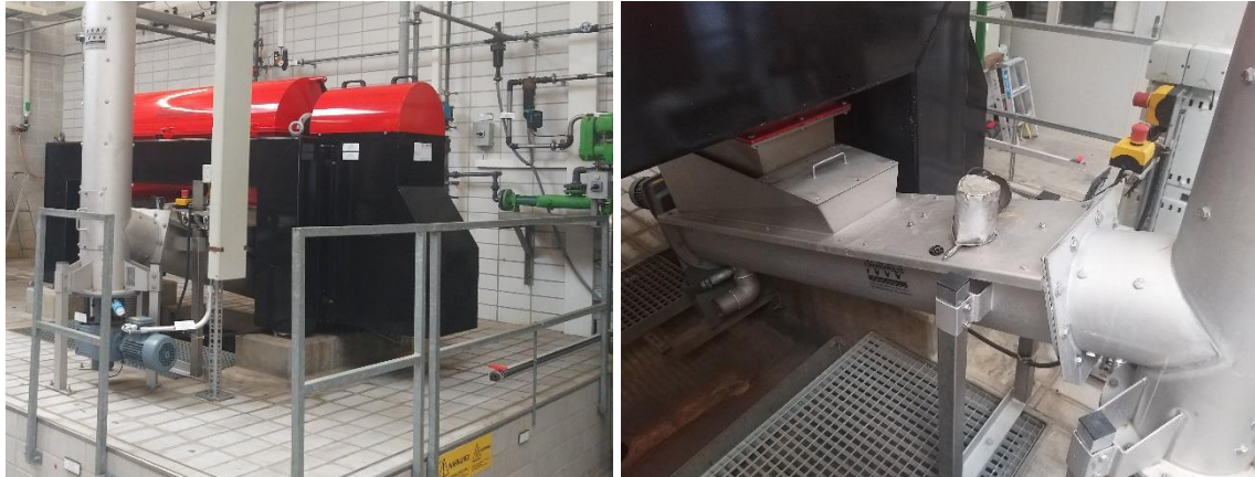
Abbildung 1: Dekanter (links) und Abwurfbereich (rechts)
