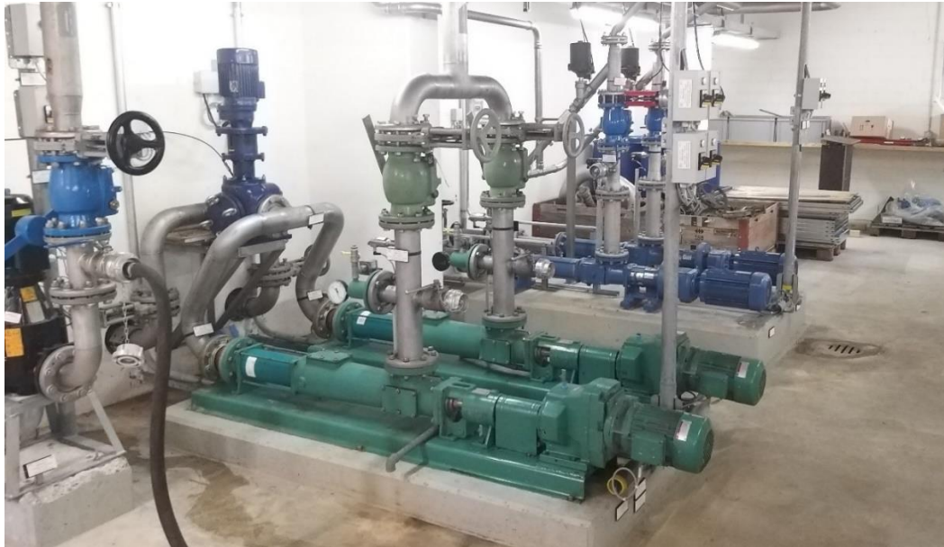
Abbildung 3: Pumpen, Leitung und Armaturen zur Förderung von Dünnschlamm (vorne im Bild) und Filtratwasser (hinten im Bild).
