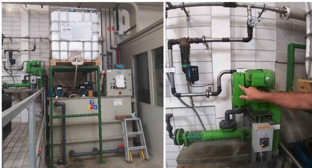
Abbildung 2: FHM Anlage (links) und FHM Pumpe (rechts)
