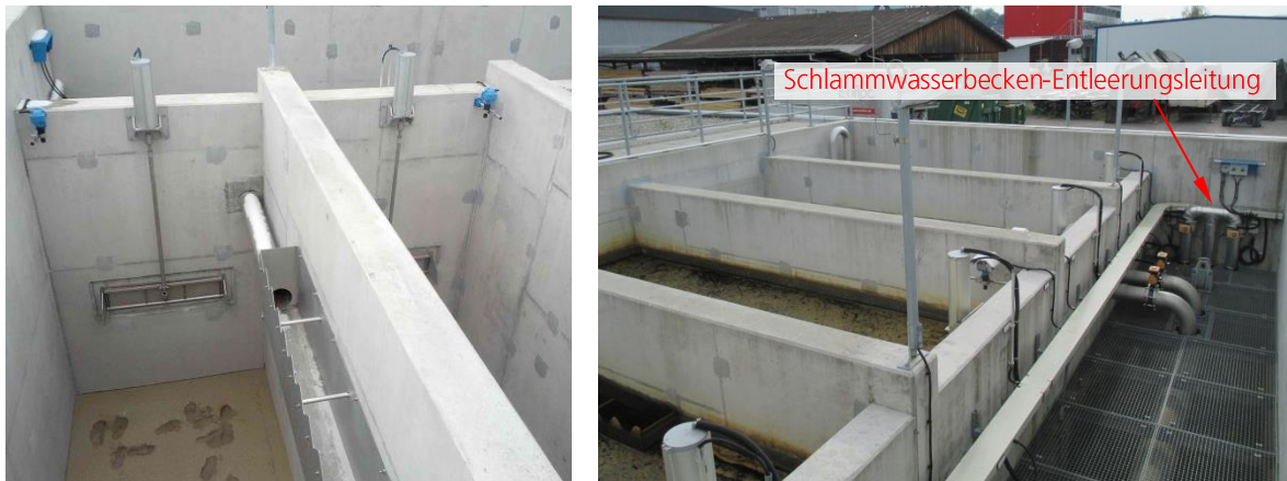
Abbildung 14: Bestehende Sandfiltration (links: Filterzelle, rechts: mit Bedienebene über Schlammwasserbecken)
